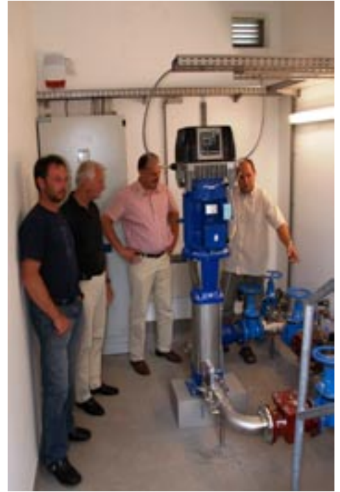
Die Bürgermeister und Wassermeister bei der Besichtigung der Übergabestation.
