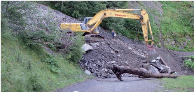
Die Forststraße in der Parzelle Egg wurde meterhoch von Geröll verschüttet
