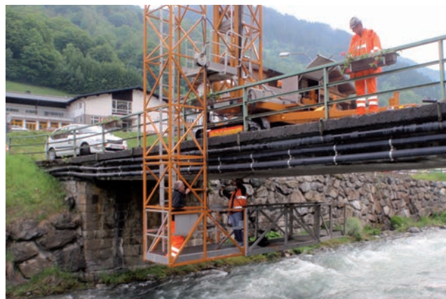
Auch die Kirchbrücke wird demnächst einer Sanierung unterzogen oder eventuell sogar erneuert
