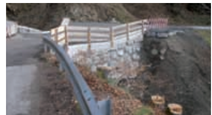
Verbauung des „Endbaches“
