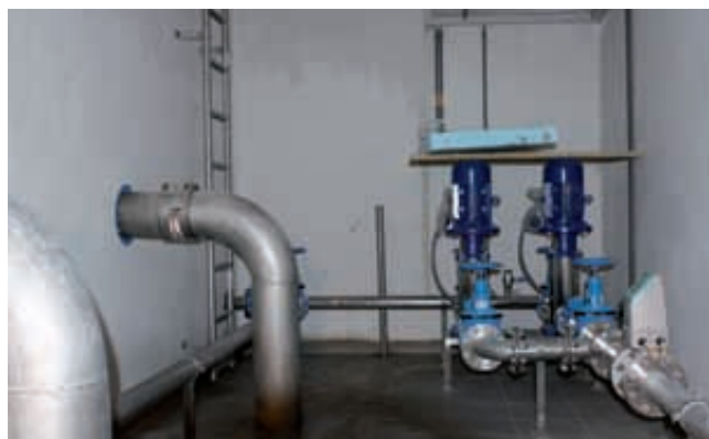
Die Druckerhöhungsanlage im Schiebekeller
