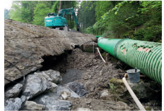
Sanierung der bestehenden Uferverbauung mittels Grobsteinschichtung in Beton verlegt (Rohr seitlich wird für die Wasserhaltung benötigt)
