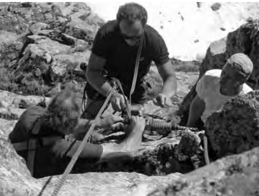
Heinz Seibert, Bert Loosli und Lothar Holl bei der Bohrung zum Anbringen einer Klettersicherung.
