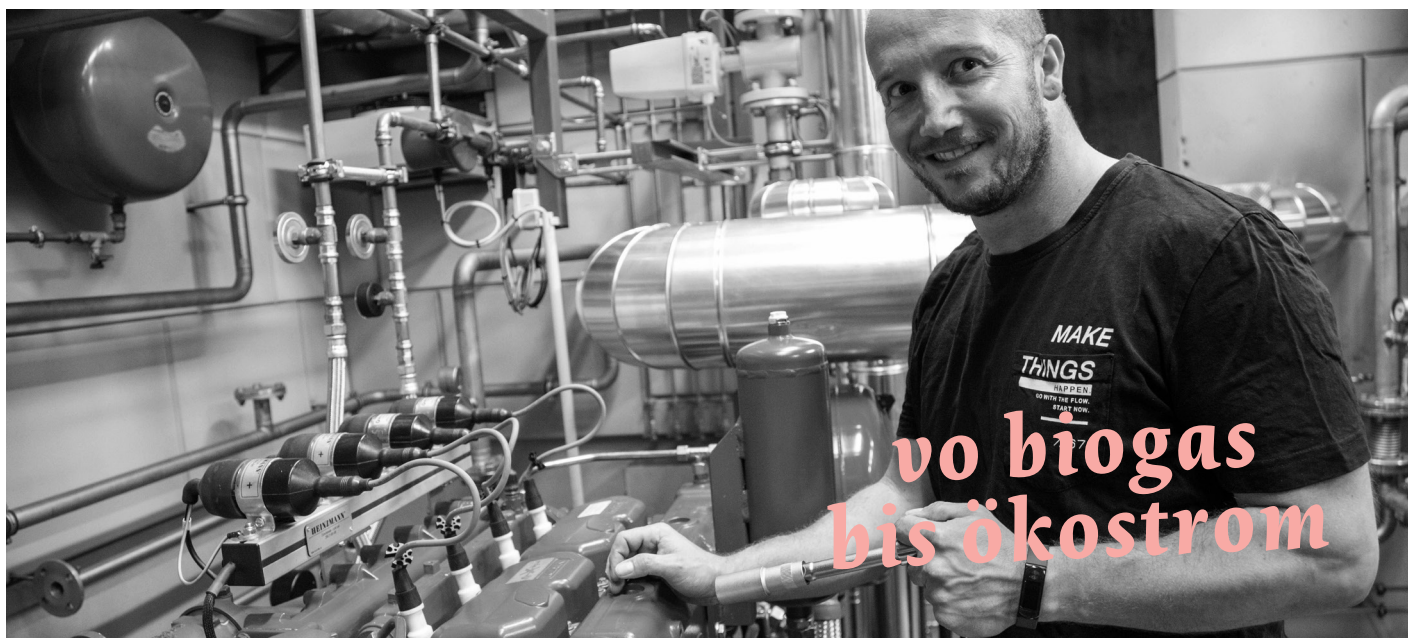
Der stellvertretende ARA-Betriebsleiter Christopher Brunold kümmert sich um die Servicing der Blockheizkraftwerke bei der ARA Montafon.
