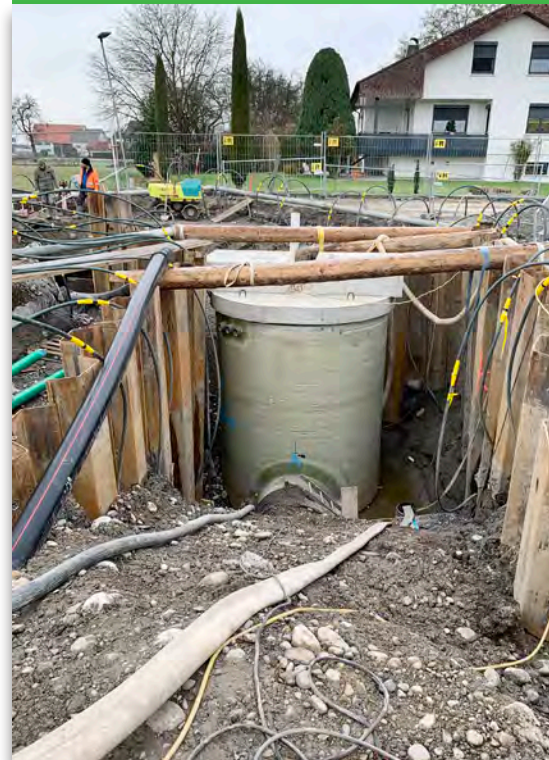
Baumaßnahmen im Bereich Mühlwasen für den Anschluss von Kanal, Wasserversorgung und der Erdgasleitung.
