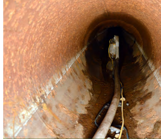
Massive Korrosionserscheinungen am Stahlrohr der alten Druckleitung
