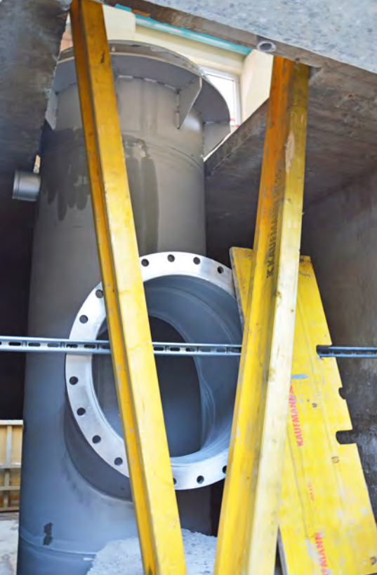
Der Anschlussstutzen zur Druckleitung
