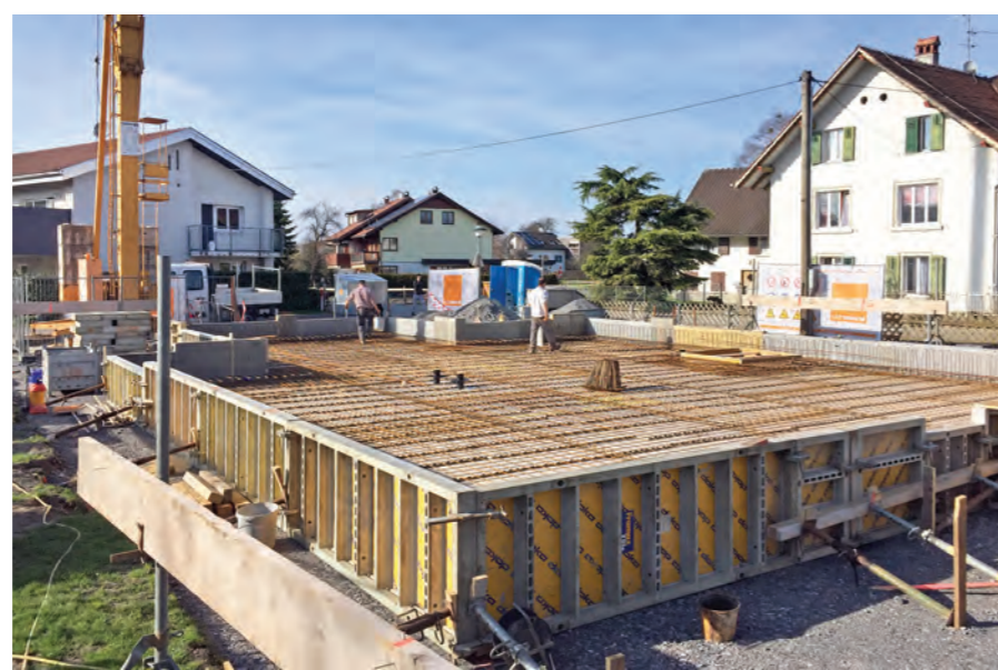
Bürgermeister Ernst Blum und TR Bmstr. Gerhard Wimmersberger beim Lokalaugenschein bei der Baustelle im Riedle. Inzwischen ist der Neubau bereits erheblich fortgeschritten (rechts).
