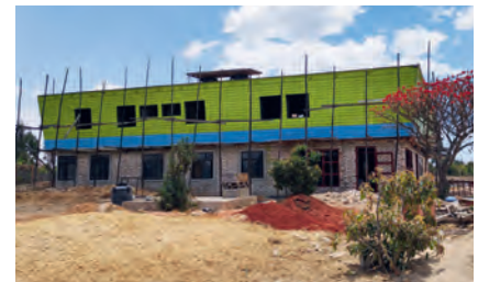
Das im Bau befindliche Seminarzentrum war aufgrund neuer Technologien im zweistöckigen Holzbau mit Stampflehmwänden herausfordernd.
