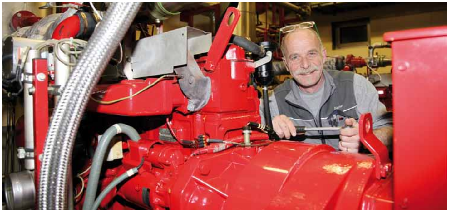
Klärwärter Günther Doblinger ist seit vielen Jahren ein fester Bestandteil des ARA-Teams. Er hat in den vergangenen Jahren unter anderem die Blockheizkraftwerke betreut und wird auch kurz vor seiner Pensionierung die neuen Maschinen noch mitaufbauen.
