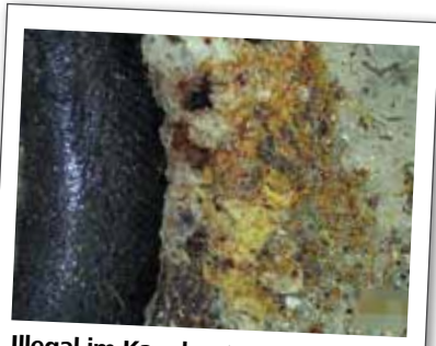
Illegal im Kanal entsorgte Küchenabfälle werden geahndet.
