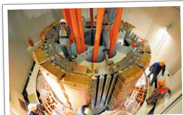
Das Rodundwerk II der Illwerke wurde nach einem Brand um rund 65 Millionen Euro komplett saniert.
